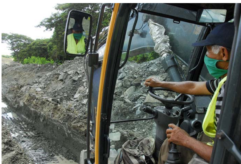
La dureza del terreno es uno de los principales obstáculos para un avance más rápido del CPI. Luis Mora, operador de la retroexcavadora que abre la zanja donde se colocarán las tuberías, lidia con "esa roca azul, guapa de verdad", cada día.
