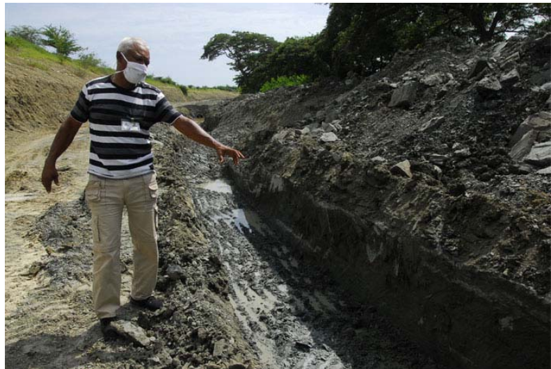
Los atrasos en las obras civiles -registros, sobre todo- se compensan con el avance en el movimiento de tierra y la colocación de las tuberías, que van en paralelo, asegura Oscar Hodelín, jefe de la brigada de 20 hombres que acomete la obra.
