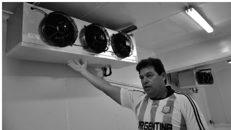
Rafael Jiménez Martínez, jefe del establecimiento, explica que los evaporadores-difusores refuerzan la capacidad de refrigeración.
