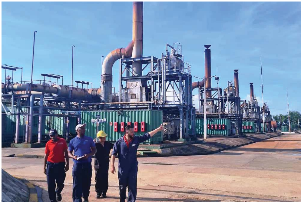
La disponibilidad de los emplazamientos de fuel oil es baja, pero sus aportes con el esfuerzo y la inventiva obrera, alumbran.
